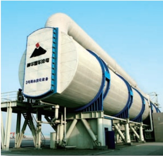
黃驂電廠海水淡化裝置
