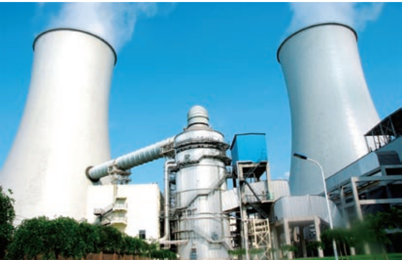
三河電廠應用煙塔合一技術脫硫裝置
